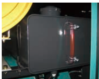
オイルサブタンク
