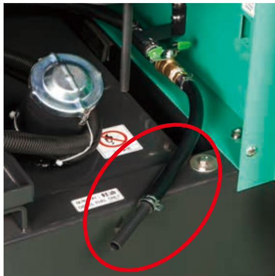
▲ オイルドレンホース
